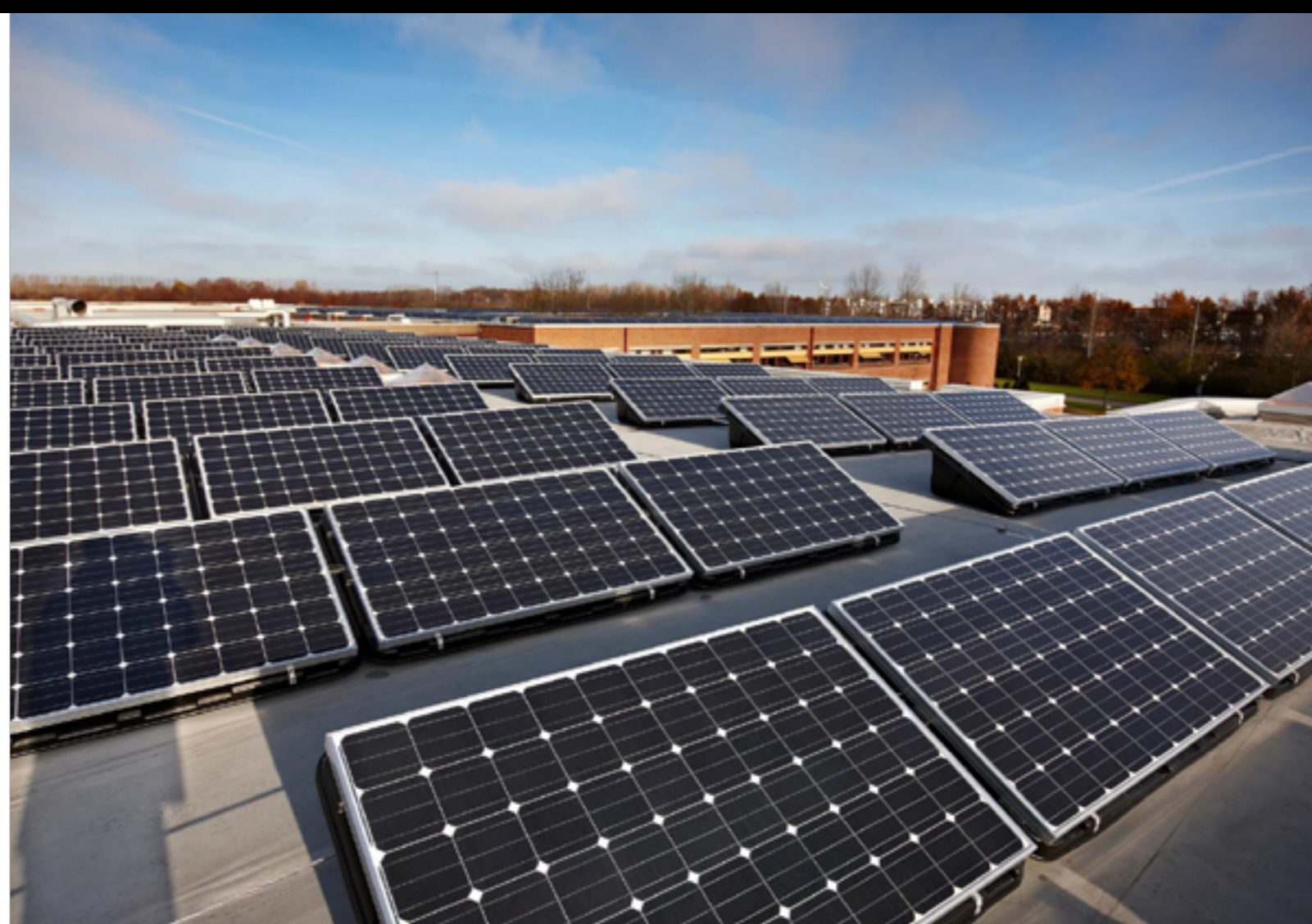
SOLCELLEANLÆG PÅ STORE TAGE ER EN AF FREMTIDENS ENERGILØSNINGER.
