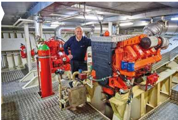
Maskinrummet på Tunøfærger.
